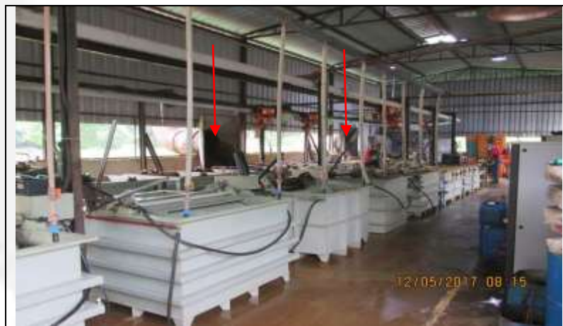
Foto 3: galpão da galvanoplastia com os recipientes contendo solução de zinco e 02 exaustores com filtros de manga indicados pelas setas vermelhas
