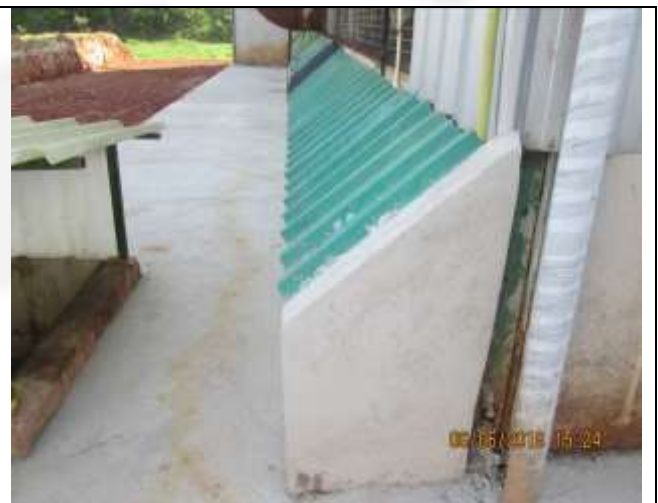
Foto 4: Canal do efluente líquido da galvanoplastia para a ETEi
