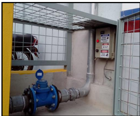
5) Um dos poços tubulares.
