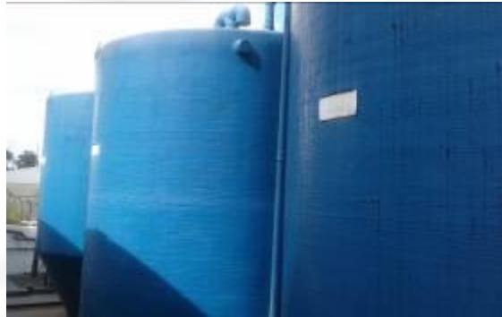
Foto 02. Estação de Tratamento de efluentes domésticos.
