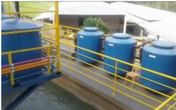
Foto 01. Estação de Tratamento dos efluentes industriais.
